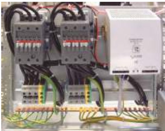
AC-Anschlußfeld mit Schützen des Netz- und Anlagen-Schutzes (mit Rückmeldekontakt) / AC input panel with contactors of the automatic isolation unit
