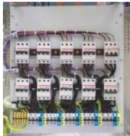
AC-Anschlußfeld mit Automaten / AC input panel with breakers
