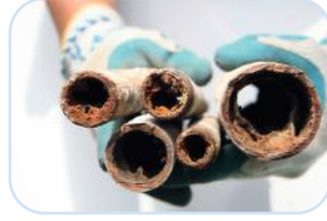
Su Tesisatında Kireçlenme
