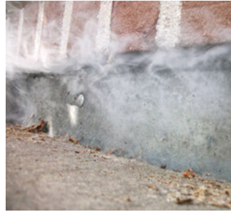
Bir yeraltı otoparkının üst kısmındaki duvar bağlantılarında sızdırmazlık sorunu olduğunun kanıtı.
