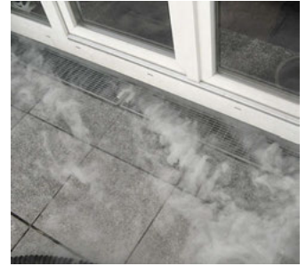
Bir çatı terasının hatalı sızdırmazlık sistemi.
