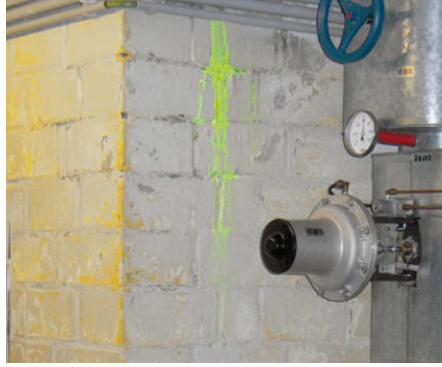
Uranin uygulama ve UV kontrolü yoluyla binadaki su taşıyan sızdıran bir hattın yer tespiti.
